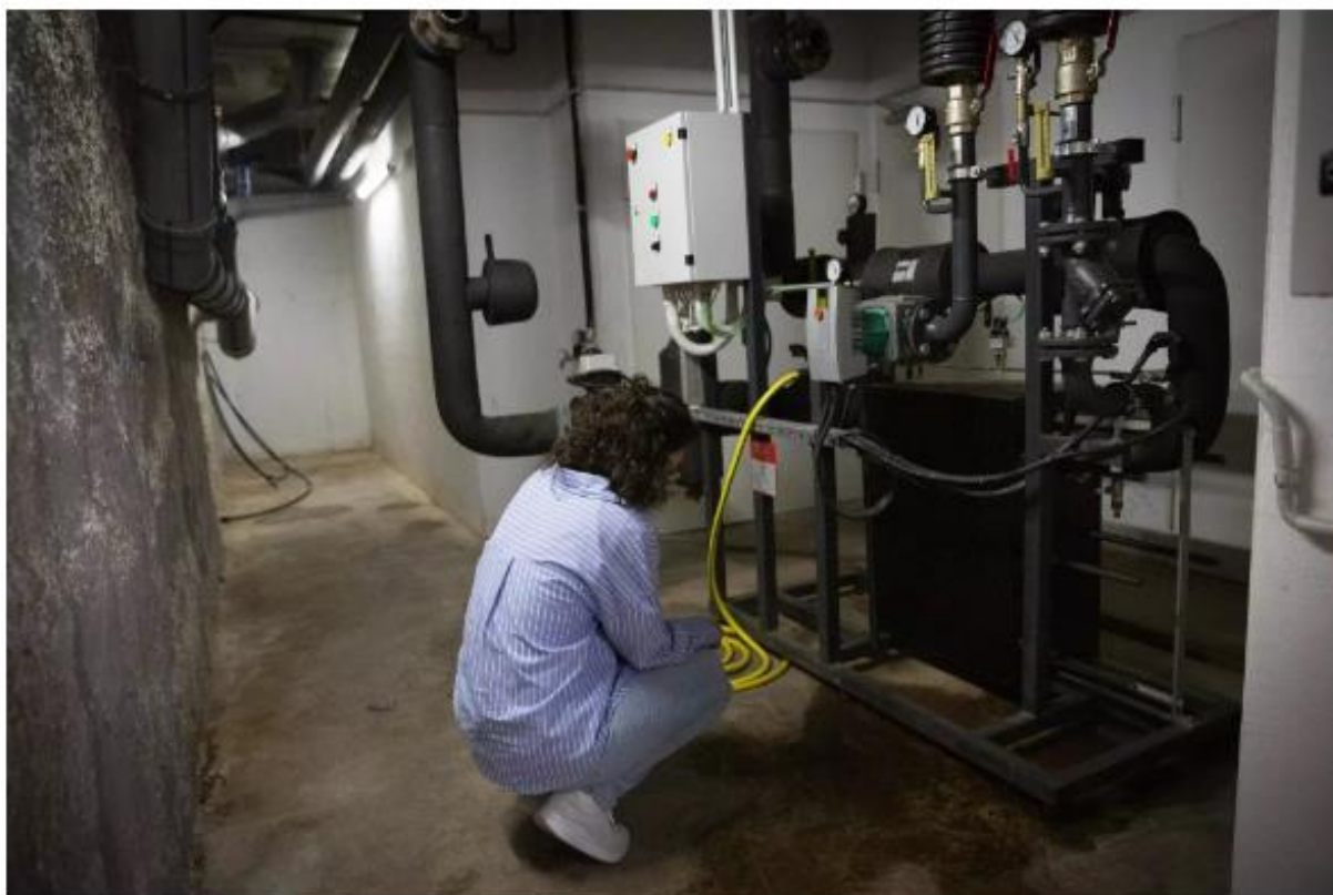
Subestación de biomasa de un bloque de protección focial de la Marina del Prat Vermell / ELISENDA PONS
